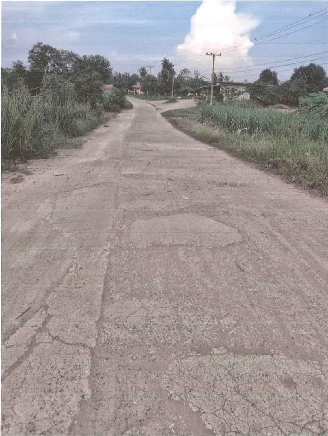
รูปถ่ายของถนนคอนกรีตที่ชำรุด
